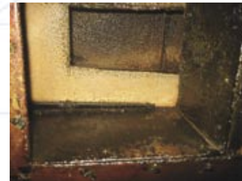
Fettrückstände in den Kanälen eines Lüftungssystems mit unwirksamer Filterleistung
