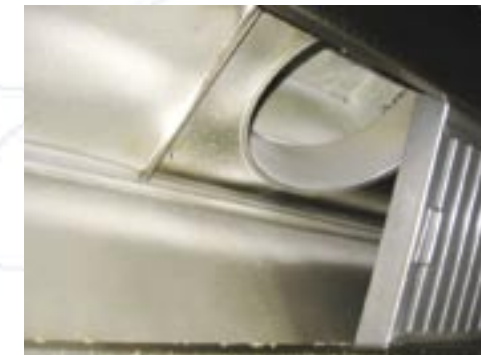
Innenansicht einer Haube ausgerüstet mit KSA-Fettabscheidern, 18 Monate nach der Installation
